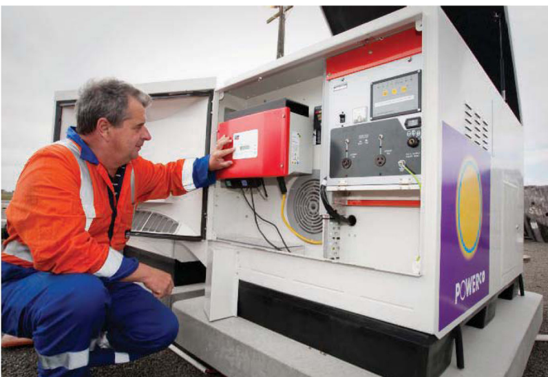
Kỹ sư Ken Pattie (Công ty điện lực Powerco), tác giả của ý tưởng về môđun nguồn điện, đang kiểm tra hệ thống điện độc lập.
